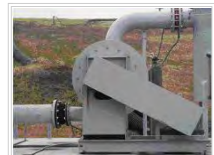
Landfill gas blower.
